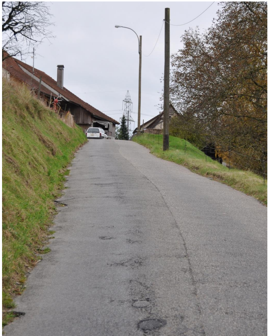
Die Gemeindestrassen müssen teilweise saniert werden.
