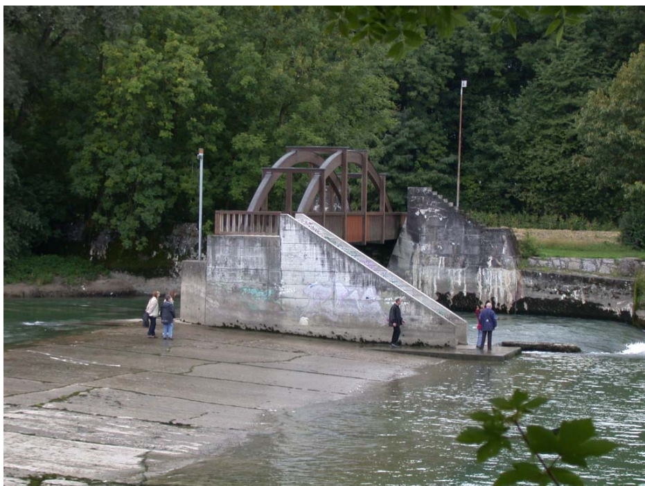
Sanieren oder ersetzen? Schwellisteg im Bally-Park
